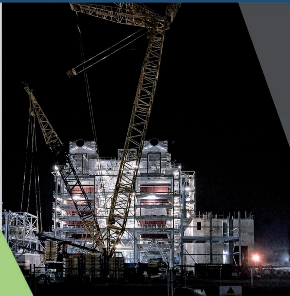
Montaż dwóch kotłów o mocy 26 MW e wraz z wyposażeniem i rusztami w spalarni odpadów Beddington (South London) o przepustowości rocznej 275 000 ton/rok w Wielkiej Brytanii
