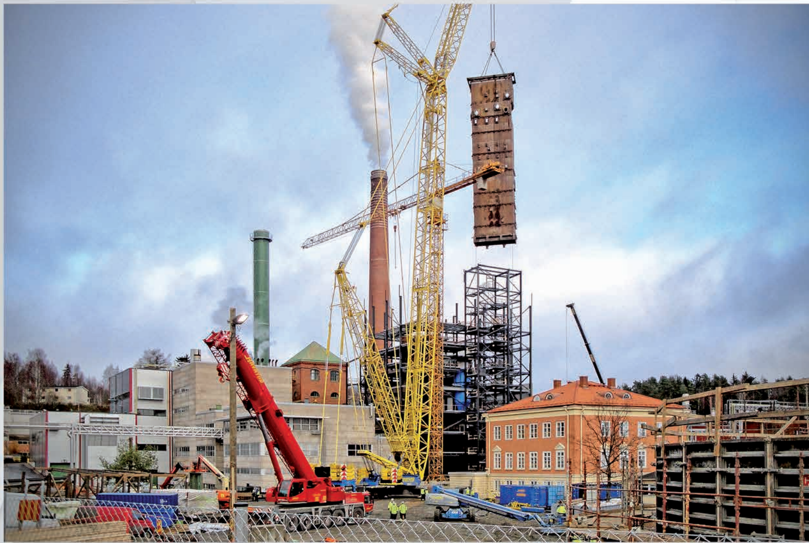
Montaż kotła BFB na biomase z wyposażeniem i rurociągami niskociśnieniowymi w elektrociepłowni HaVo w Kyröskoski w Finlandii
