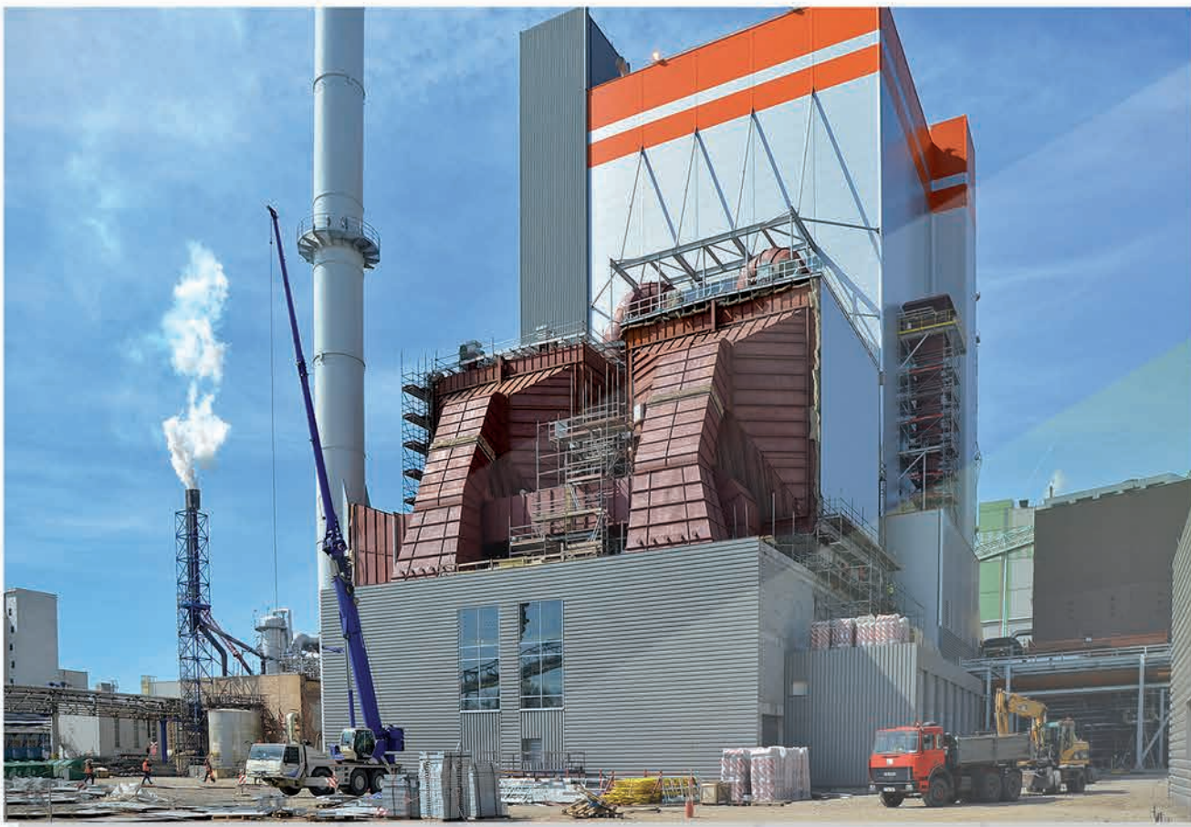
Montaż kotła sodowego (Recovery Boiler) o wydajności 2 300 tds/d i dwóch elektrofiltrów w papirni Mondi Świecie w Polsce
