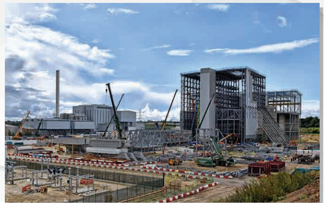
Spalnia odpadów w Ferrybridge w Wielkiej Brytanii
