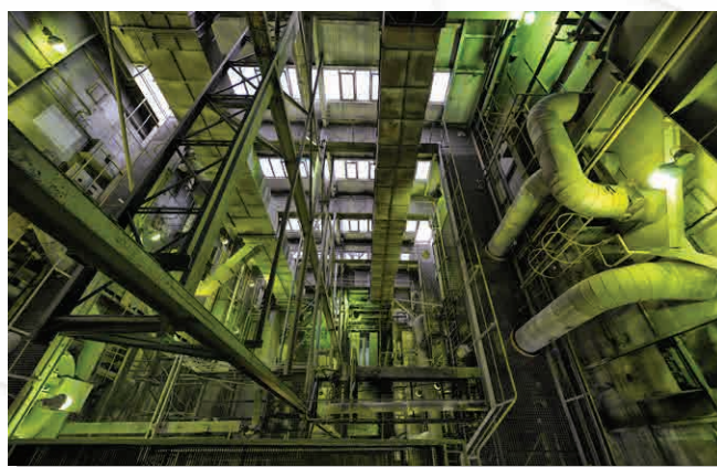
Zakłady Azotowe „Puławy” S.A.
