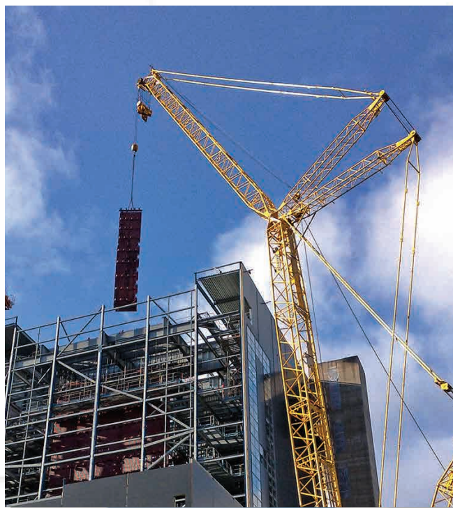
Elektrociepłownia w Jyväskylä w Finlandii
