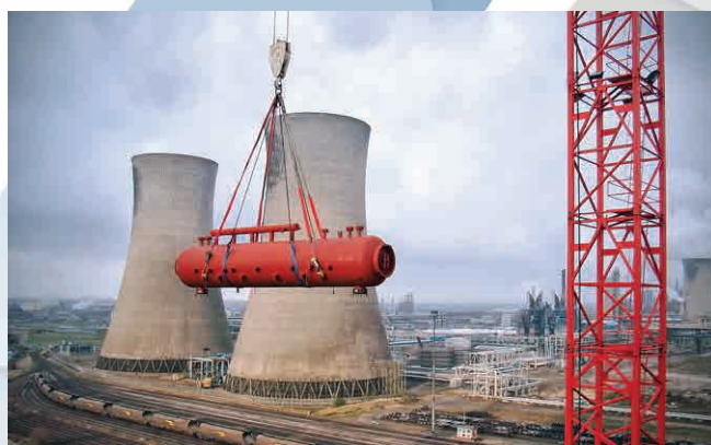
Spalarnia odpadów w Billingham, Cleveland w Wielkiej Brytanii
